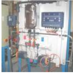
Cl 2 generator (CIP)
